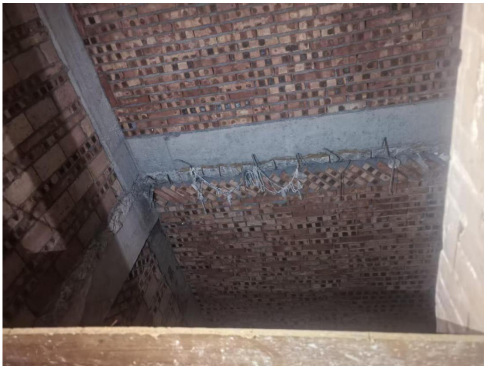
图 6：被冲破的 4 楼水平安全网
