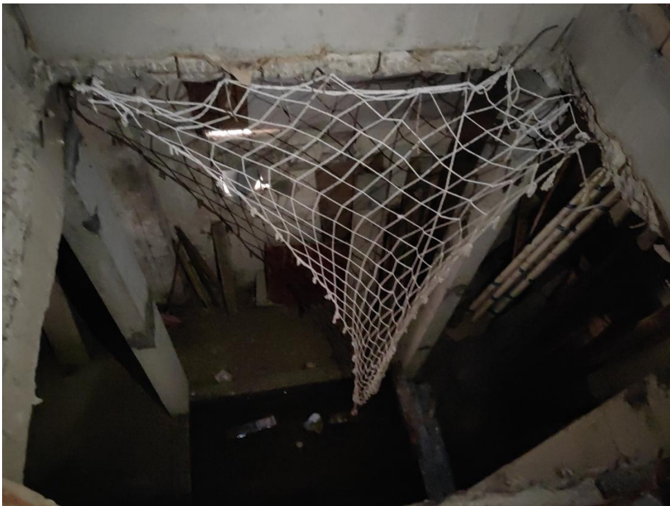
图 7：被冲破的 2 楼水平安全网
