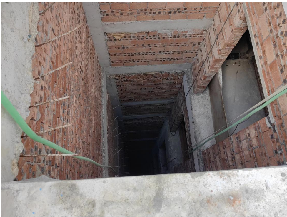
图 8：电梯井道 5、6、7 等楼层未设置水平安全网
