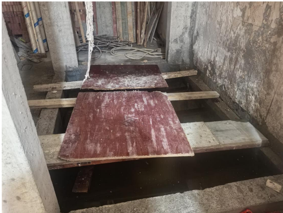
图 9：一楼电梯井底及被压断的木板
