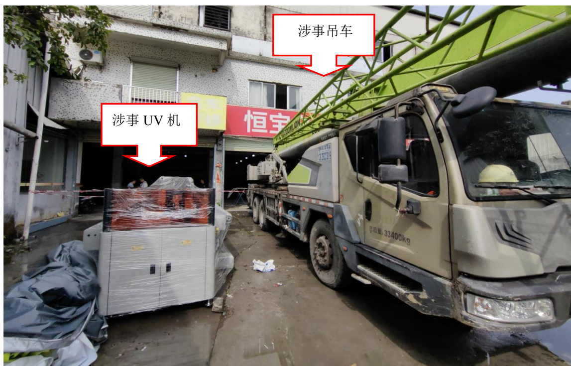
图 1 事故发生现场（因救援有部分移动）
