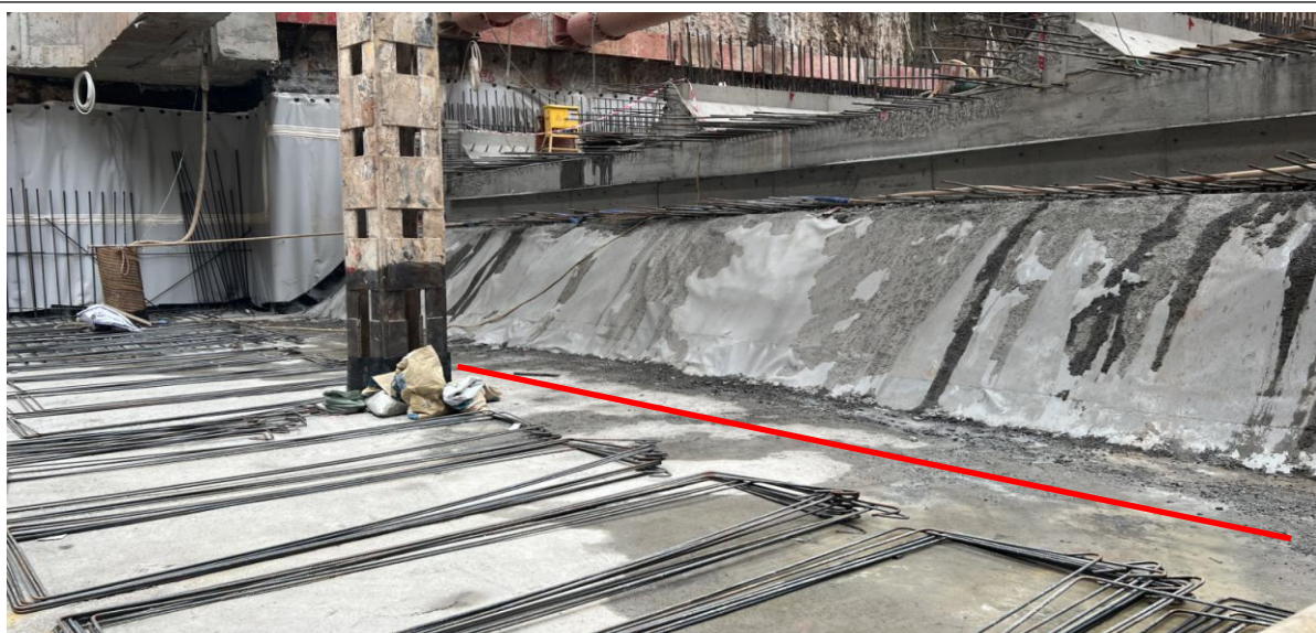
图 2 涉事盘扣架已被拆除
