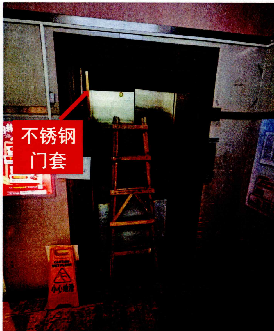
图 1 山水华庭一栋 2 单元 1 楼大厅电梯情况
