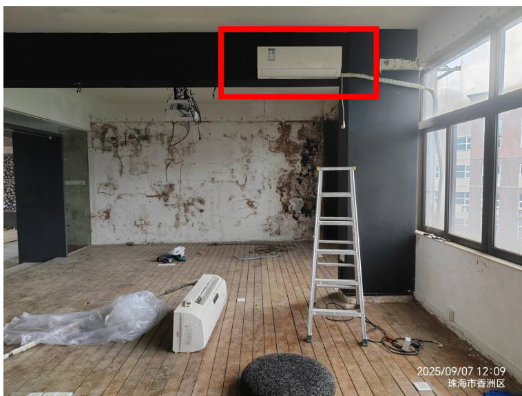
图 6 建设大厦 6 楼北侧室内地面摆放 1 台从南侧拆除的空调内机，红色框为涉事空调外机铜管连接的空调内机（插头未插电）。
