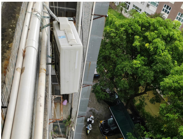
图 3 建设大厦 6 楼空调外机连着支架呈垂吊状，支架东侧已与墙体脱离，支架西侧通过两枚螺丝连接墙体。
