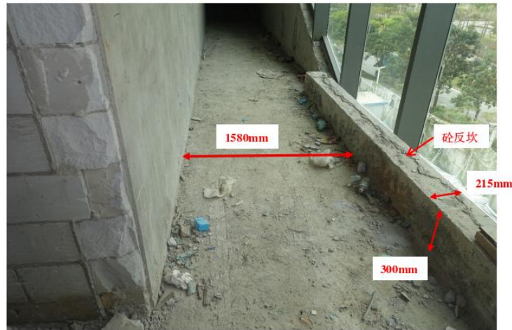
图 11 3 层西侧通道事故现场相关尺寸
