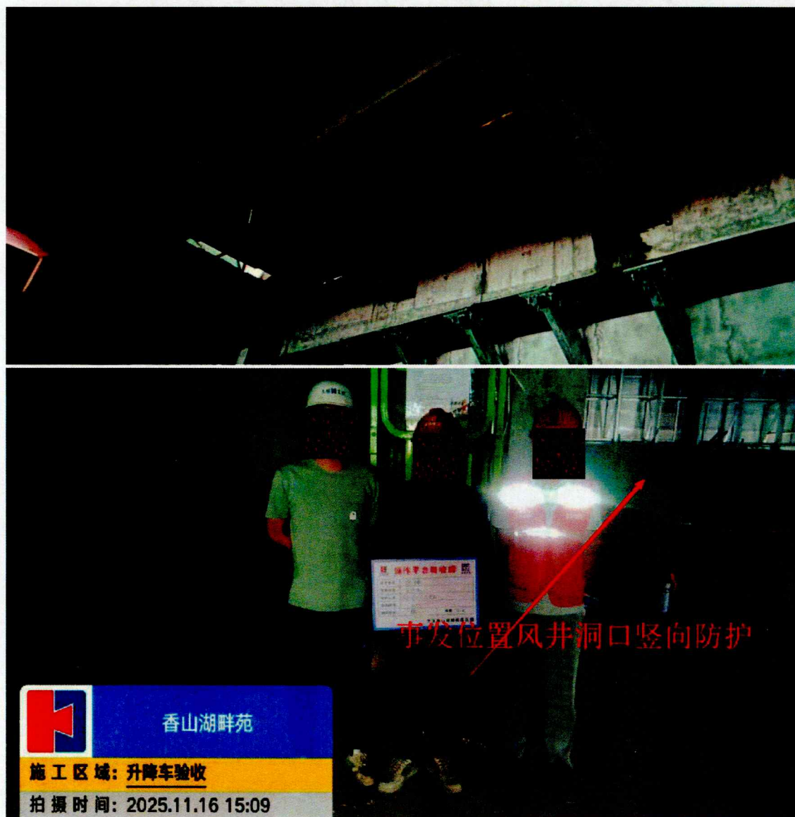
图 4 监理单位提供的事发洞口封闭情况
