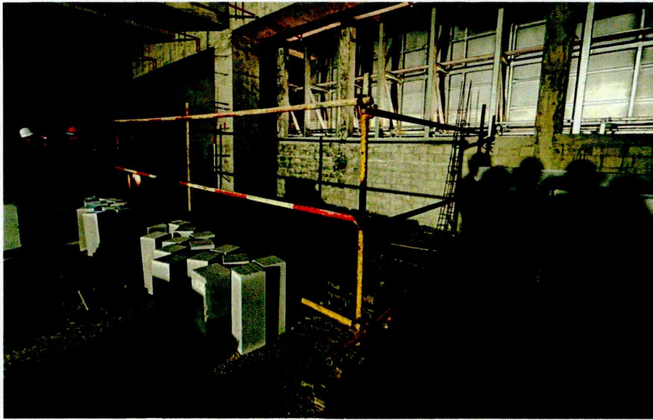
图6 事发后，洞口临时防护措施情况
