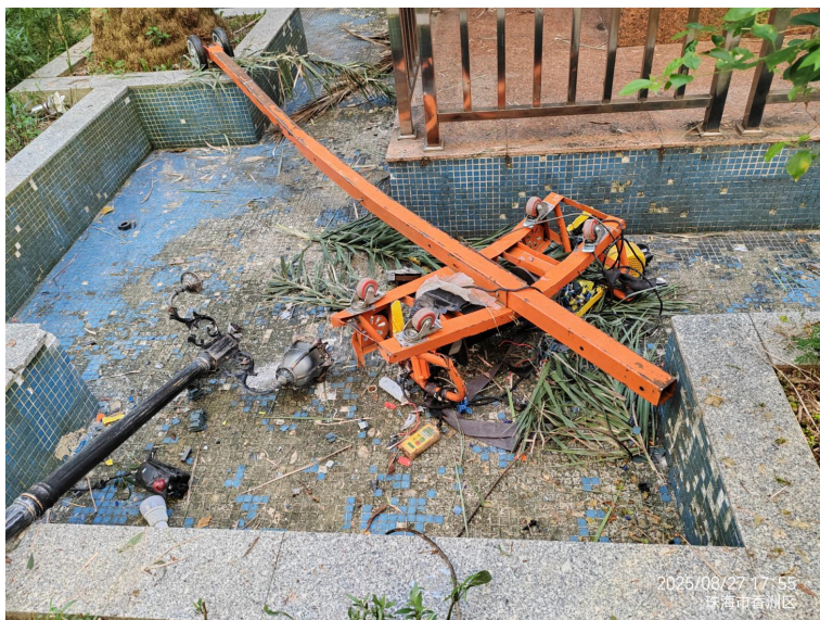
图 5 地面有个橙色的吊具，现场未能看到吊具的铭牌。吊具旁边有个黄色遥控器，已经损坏，旁边黑色的路灯杆也倒下。
