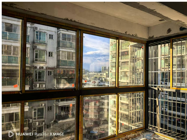
图 9 10XX 房客厅窗户铝合金框架上有黄色胶布，正面窗户外无防盗网，侧面窗户外已经安装防盗网。
