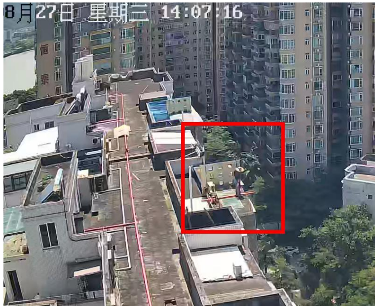
图 11 监控显示，27 日 14 时 7 分 16 秒许，南湾花园 X 栋 X 单元楼顶，熊某平站在橘色吊具横梁上，操作吊具；吊具尾部没有额外配重。
