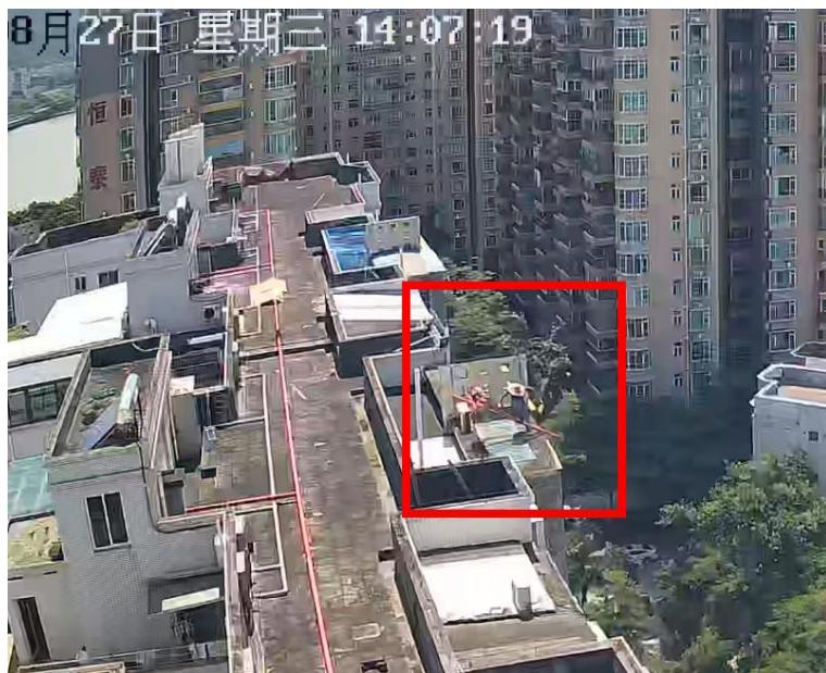
图 12 监控显示，27 日 14 时 7 分 19 秒许，橘色吊具尾部翘起，熊某平在橘色吊具横梁上压不住。
