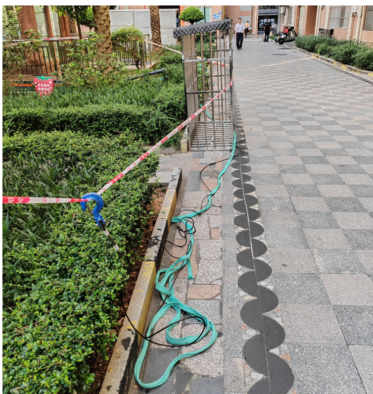
图 4 地面有钢丝绳连接蓝色吊钩，蓝色吊钩挂在警戒绳上。
