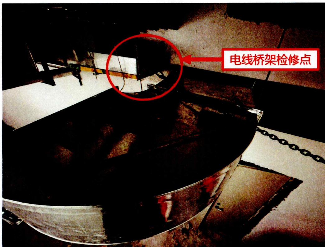
图3 事故检修点附近情况
