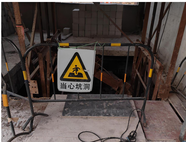
图 3 物料提升机西侧，设置了上下货出口，已被围栏封闭，围栏上面悬挂“当心坑洞”的警示标示。
