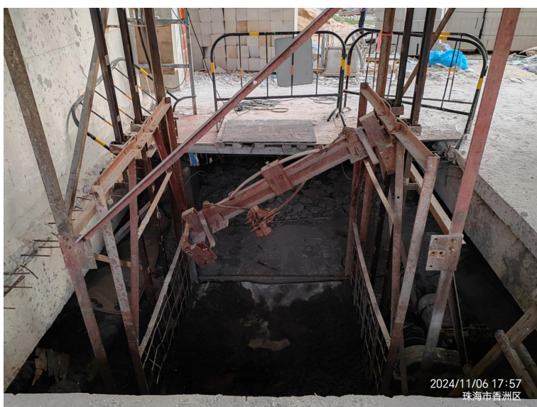
图 4 物料提升机东侧，物料提升机外架南北两侧有导轨，显示悬吊吊笼的连接件损坏。
