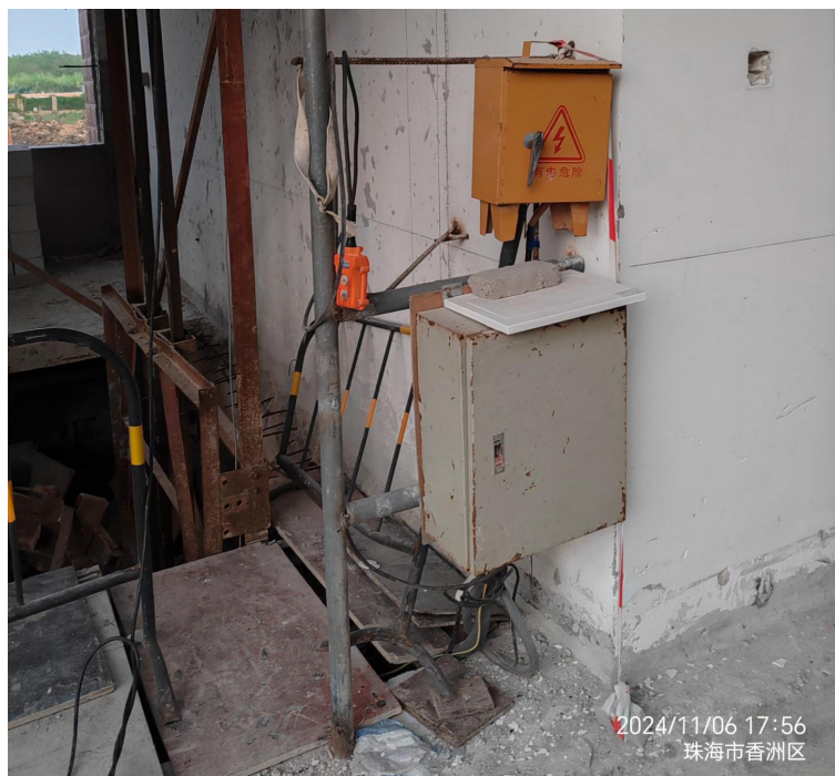
图 5 物料提升机南侧，物料提升机的配电箱靠墙壁，配电箱左边有个橘红色的控制装置（有两个按钮控制升降）。
