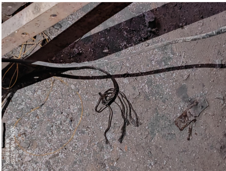
图 9 物料提升机北侧的下方，卷扬机附近的钢丝绳一端呈现断裂状态，钢丝绳上方是一条电缆（给卷扬机供电）。
