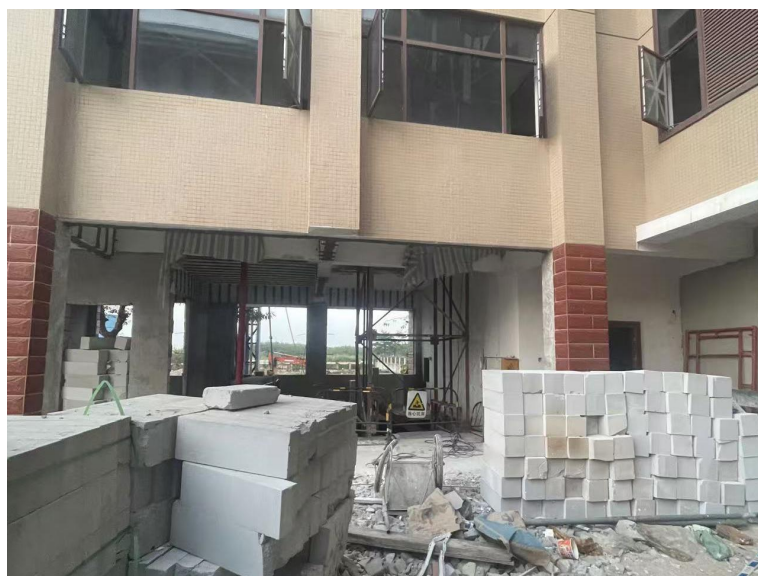
图 2 项目工地 3 号楼 1 层现场物料提升机周围有警示标示。
