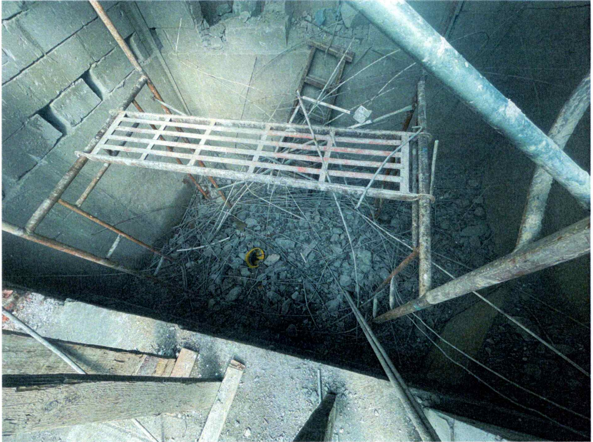
图 2 事故电梯井道底部情况
