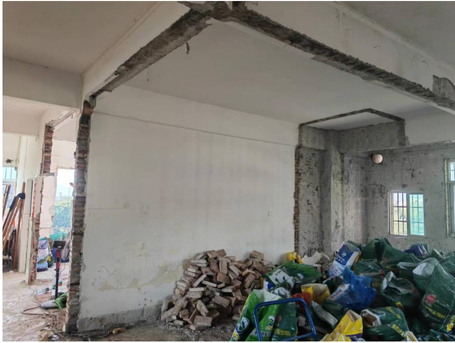
图 5 5 楼内部，很多砖头等建筑垃圾（部分装在绿色袋子）。
