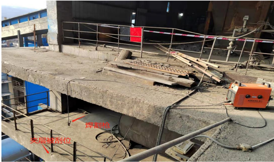
事故现场情况（照片）
