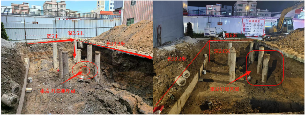
图1：事发基坑长13.2米，宽6米，深2.6米，坍塌区域为东北侧坑壁
