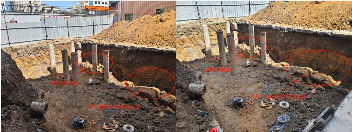
图 4：事发坍塌区域及 3 月 11 日新发现的坍塌区域
