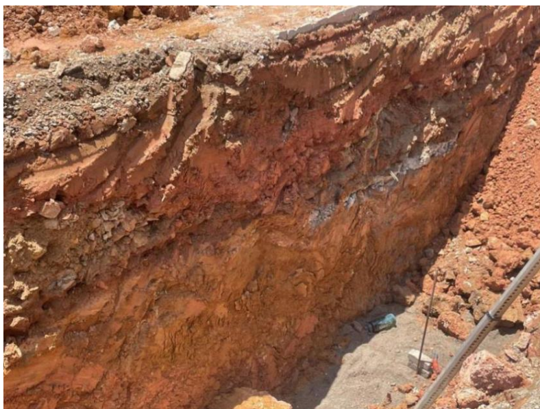
图2 边坡垂直且无支护
