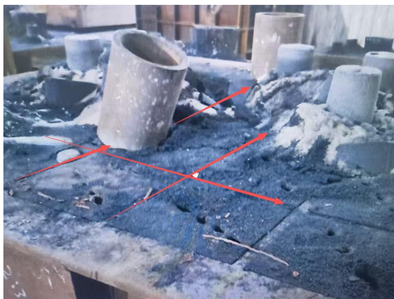
图 3 事故发生后压铁支撑钢管现状图
