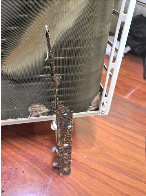
图3 南侧安装架断裂情况
