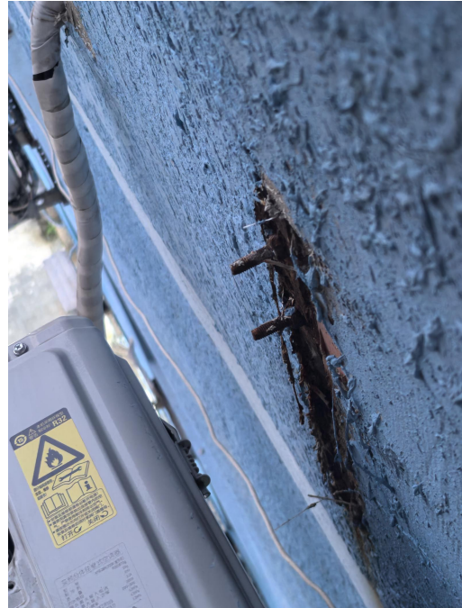
图4 南侧部分安装架残留在墙体上
