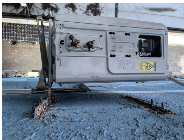
图 2 空调室外机基本情况
