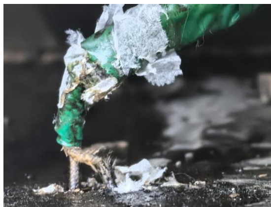
图 5 排油烟设施照明灯电源导线破损
