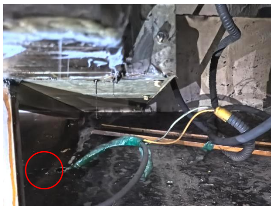
图 4 排油烟设施照明灯电源导线情况
