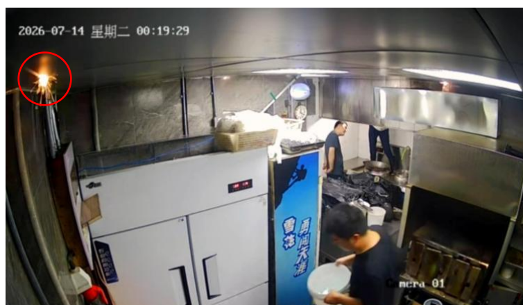
图1 厨房吊顶出现电火花
