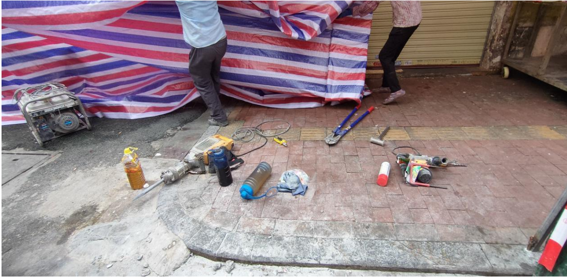
图 11 事故现场旁边摆放的作业工具
