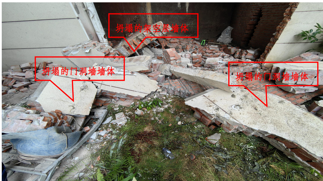
图3 坍塌的花园侧墙体及架空层隔墙
