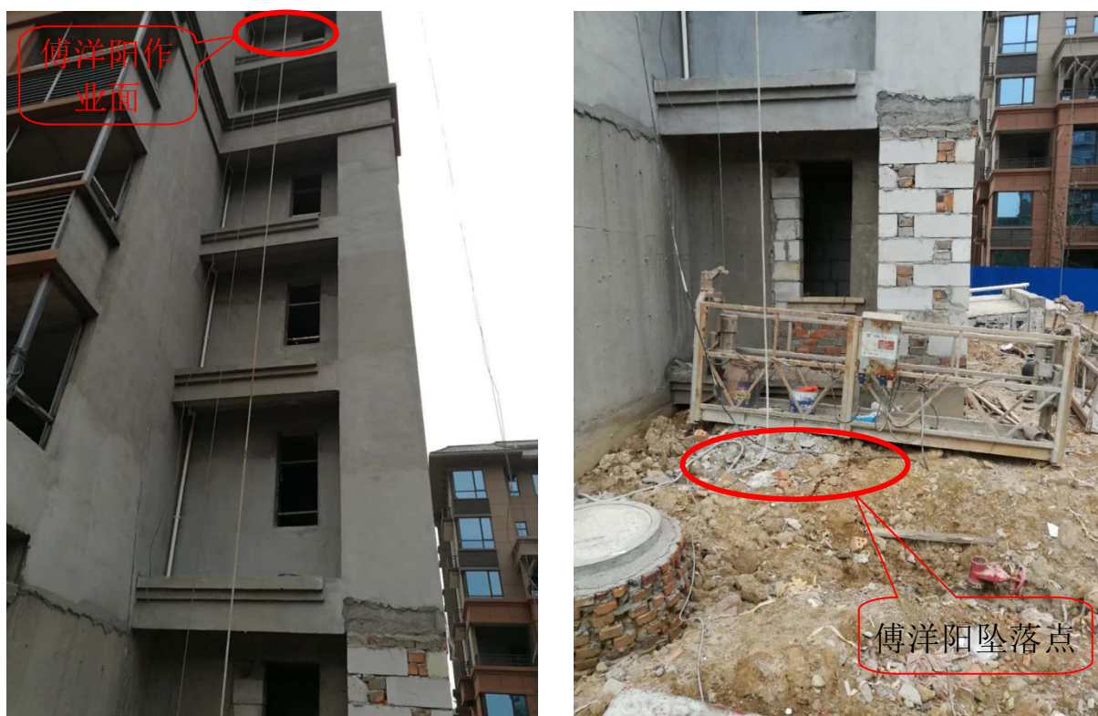
图：事故现场图片
