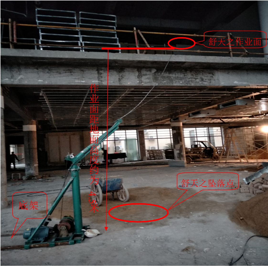
图：事故现场图片
