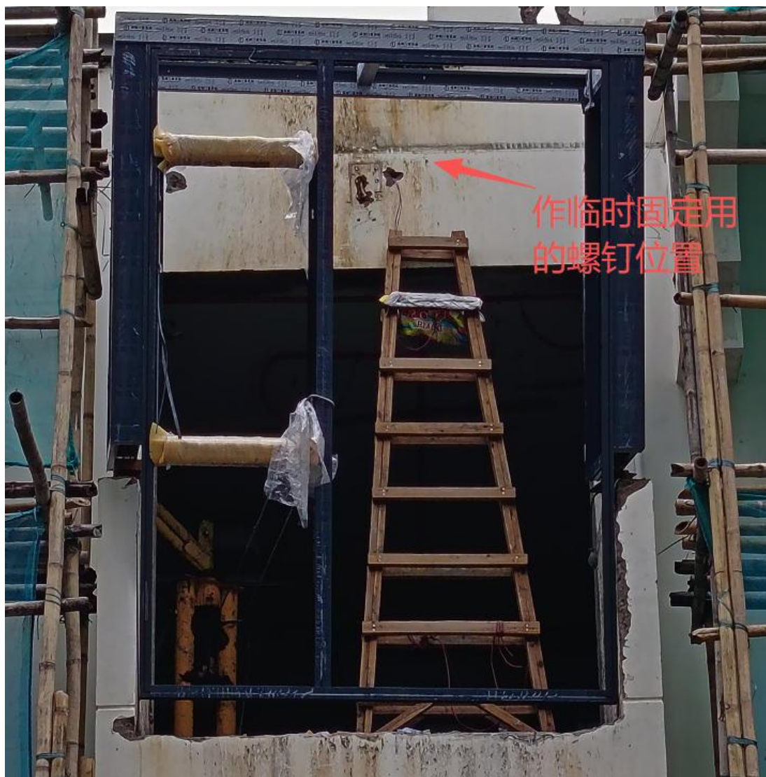
▲ 图 4：事发现场（三楼窗框仅使用螺钉进行上部临时固定，窗台尚未砌筑完成，提前开展铝窗安装作业）
