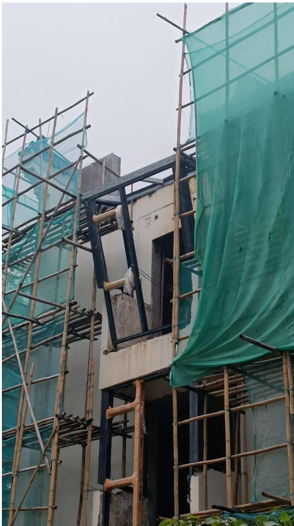
▲ 图 6：事发现场（三楼窗边临边位置未设置防护栏杆、安全立网、外脚手架等防坠落防护设施）
