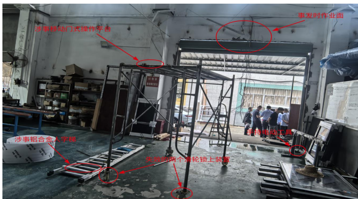
图 2：事发作业现场情况
