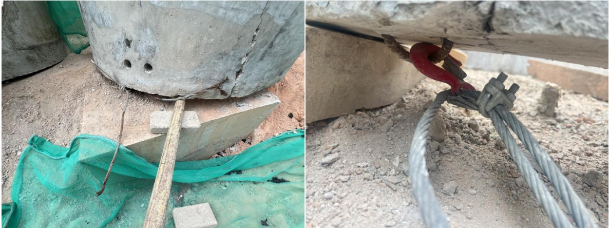
图4 涉事预制井筒吊点情况
