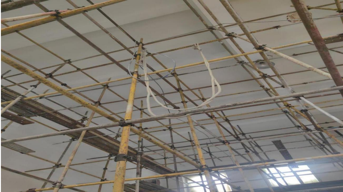
图 5 事故发生现场图片三（从低向高拍摄）
