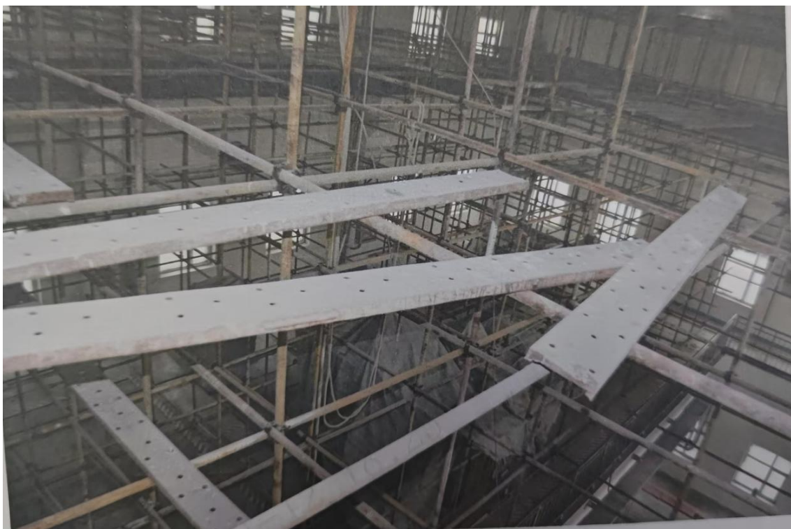
图 4 事故发生现场图片三（从高向低拍摄）
