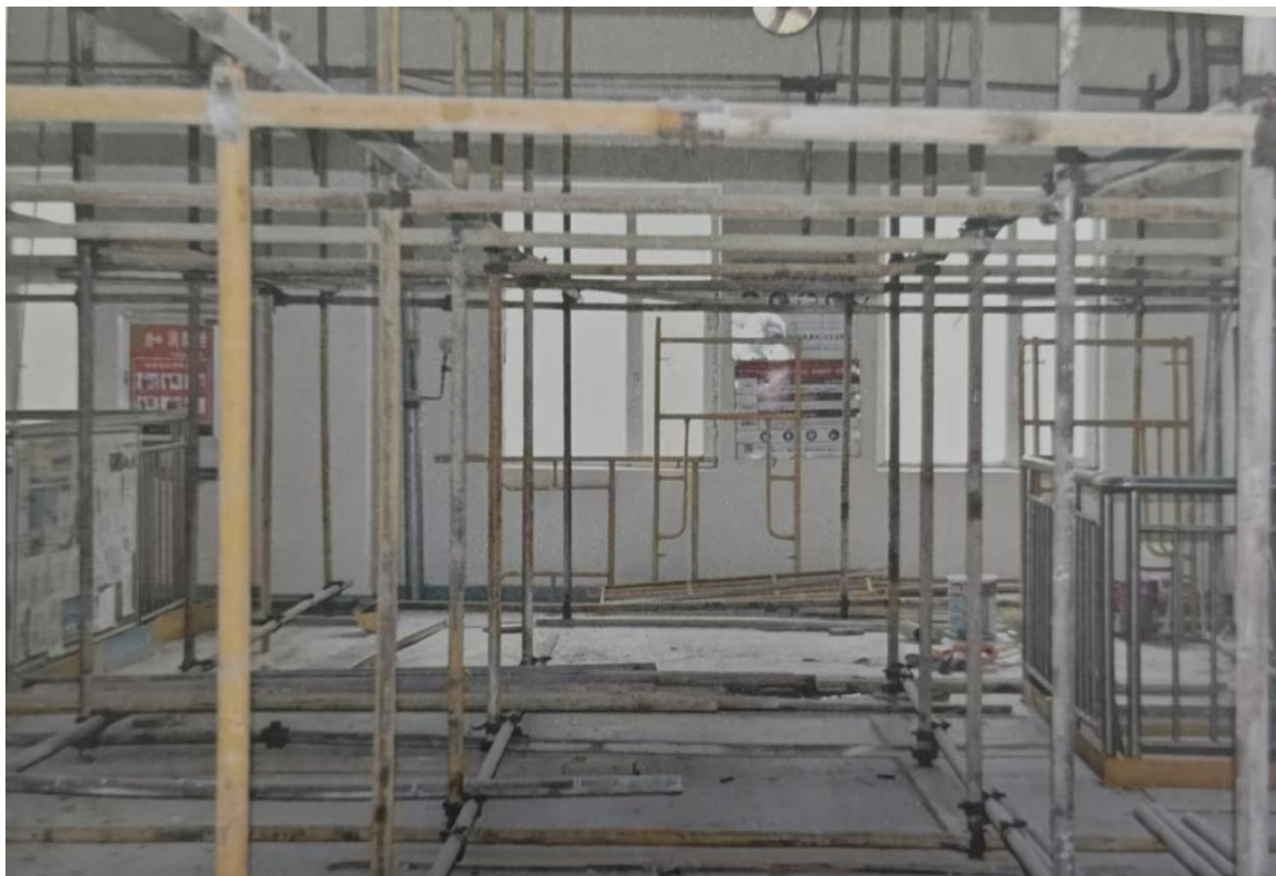
图 2 事故发生现场图片一（从南向北拍摄）
