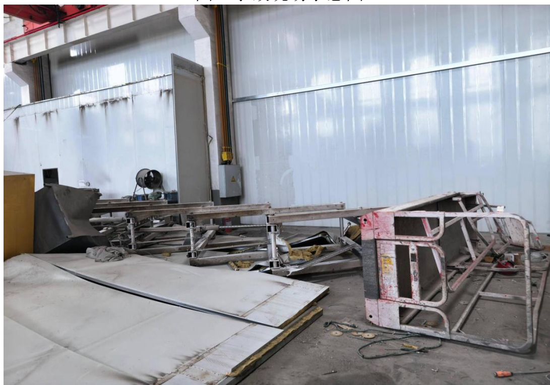
图 2 事故现场图片
