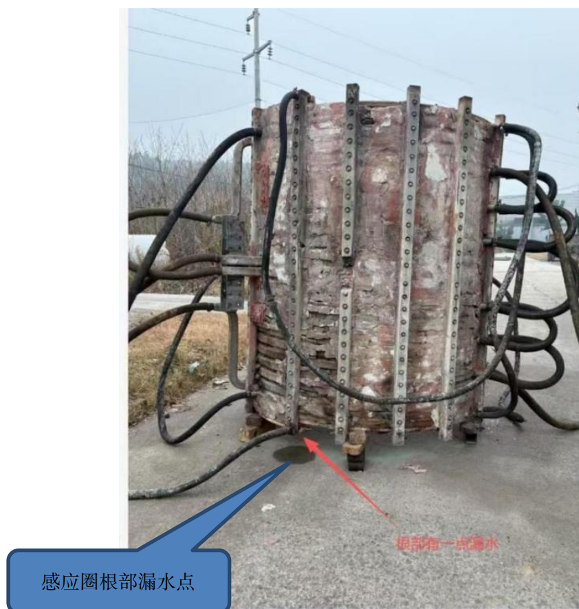
图 5 打压测试时感应圈底部渗水点
