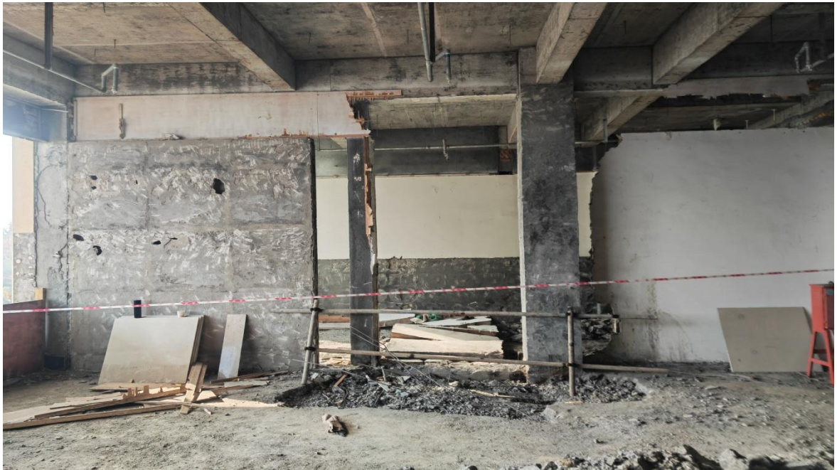
图二、事故发生在“原精神病医院”大门右侧第二个房间， 图片为大门右侧第一房间及倒塌墙体
