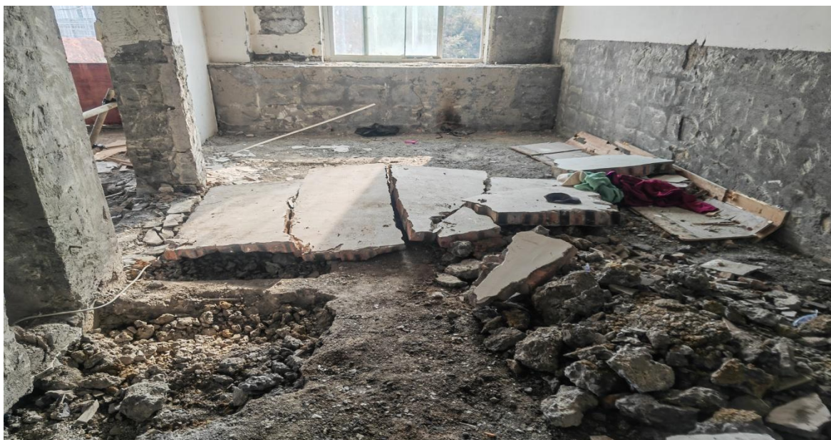
图三、事故发生房间
