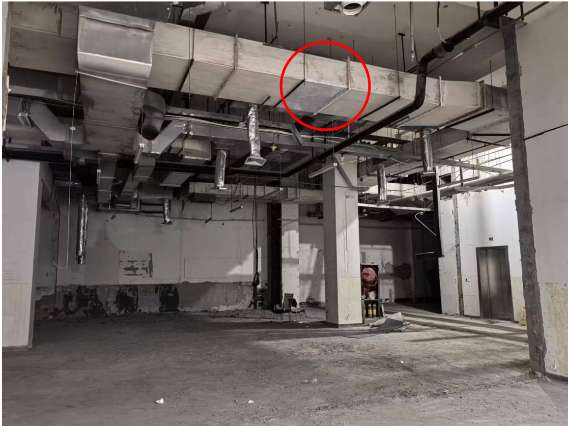
照片 2，事故作业现场（红色圈即为坍塌位置）
