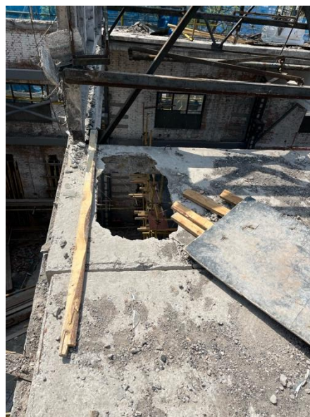
图 2-2 坠落洞口情况
