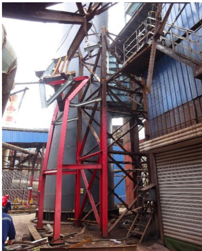
图 8-1 支架倒塌情况
