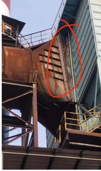
图3 除尘器入口开裂
