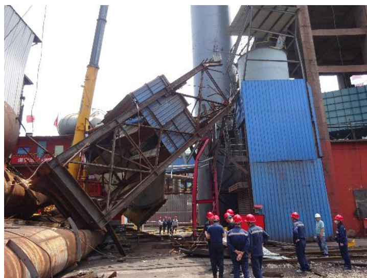
图 8-2 支架倒塌情况
