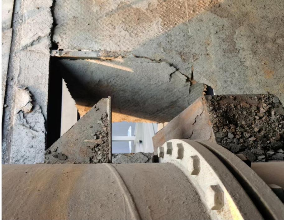
图 2 平台断裂坍塌孔洞
