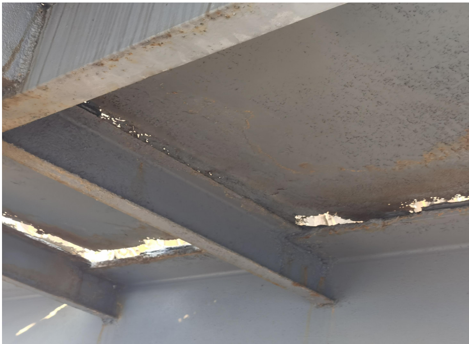
图 3 钢板腐蚀、开焊情况
