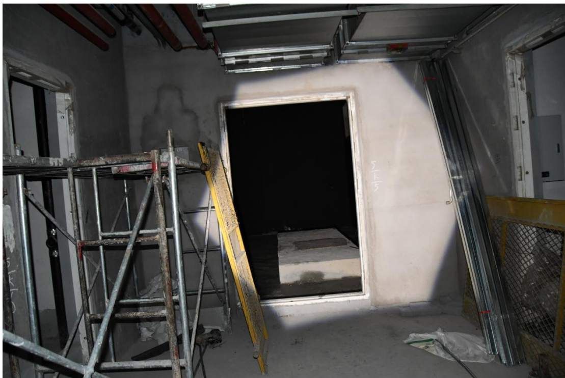
图 3 空调机房（拍摄角度为空调机房外向内拍摄）
