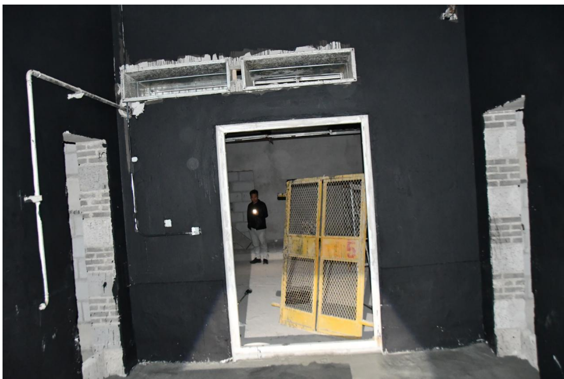
图 4 空调机房内情况（左侧 GT3 洞口为发生坠落洞口）
