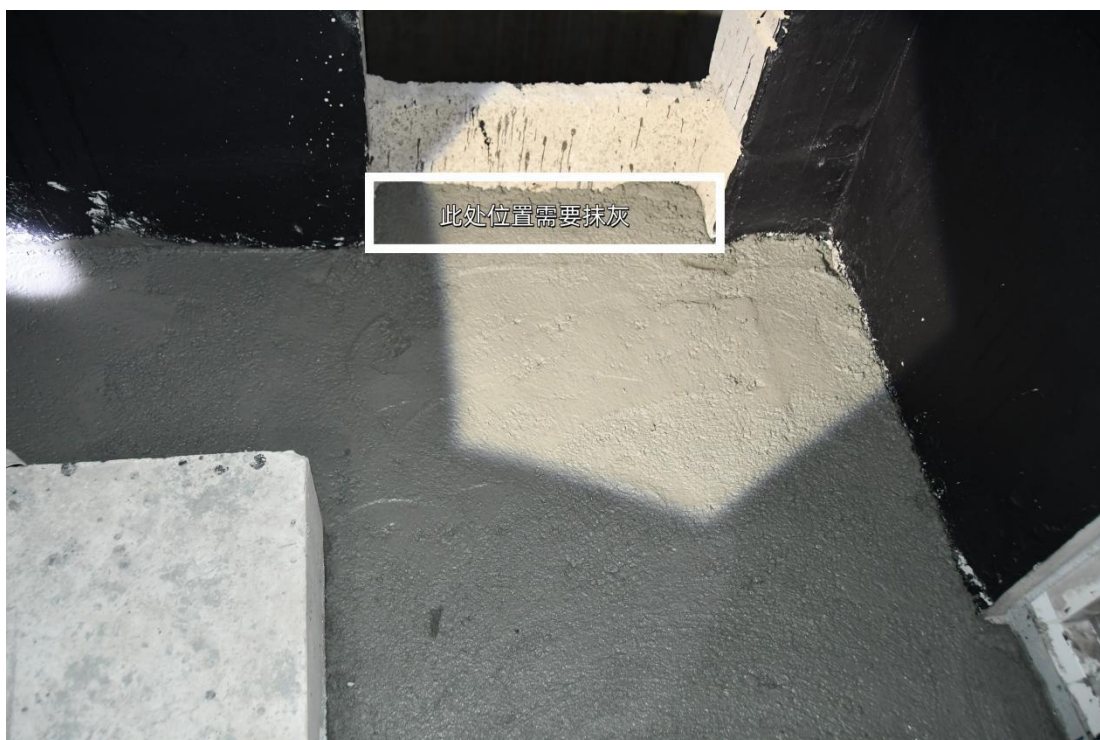
图 6 洞口防护措施下口内侧地面
