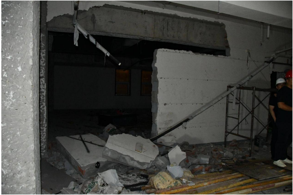
图二 屋顶未坍塌的断壁
