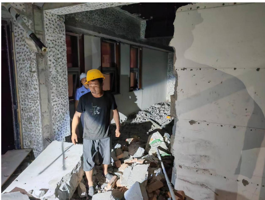
图四 事故当天坍塌墙体位置
