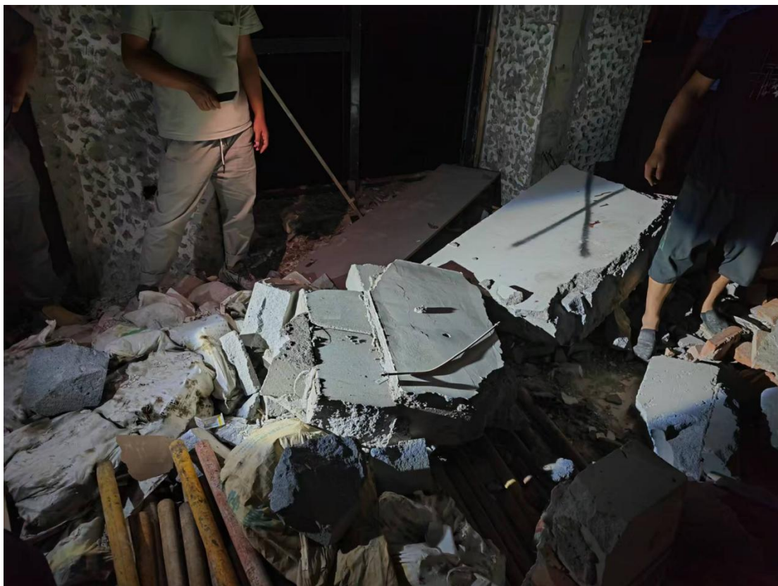
图三 事故当天坍塌后的砖块
