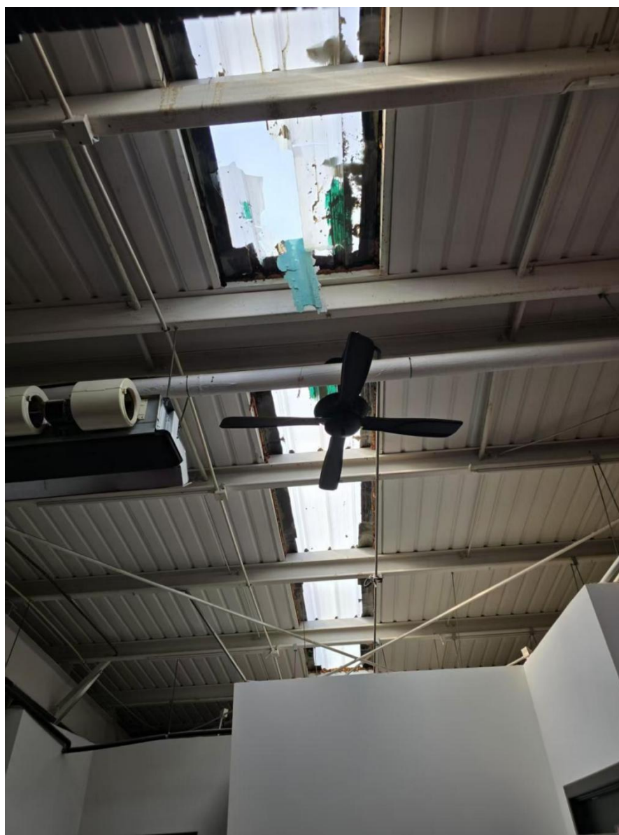
图 1 顶棚阳光板破裂（室内视角）
