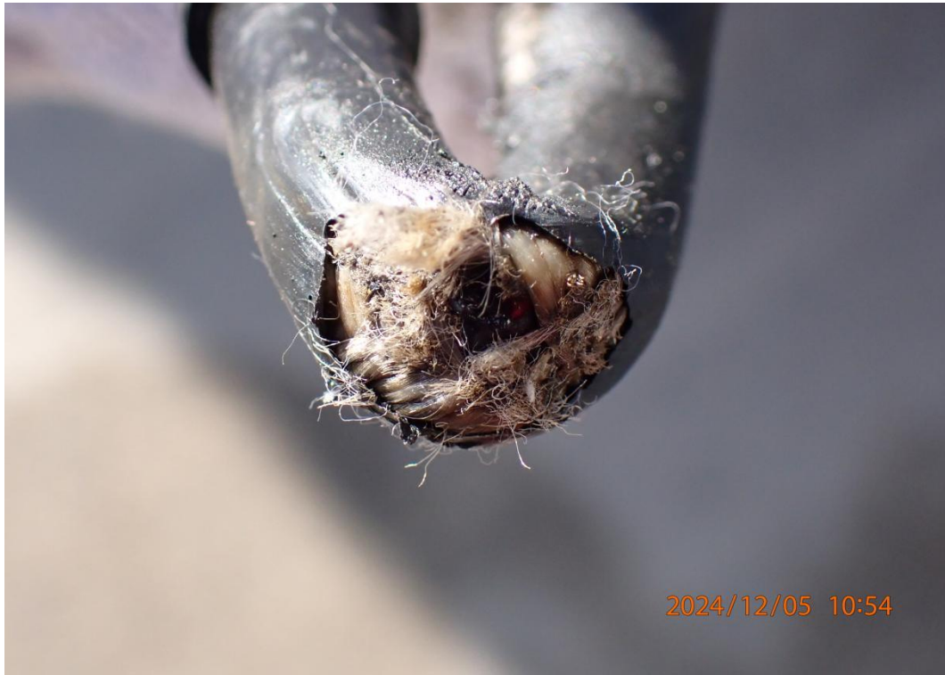
图四 液压油管有破裂痕迹
