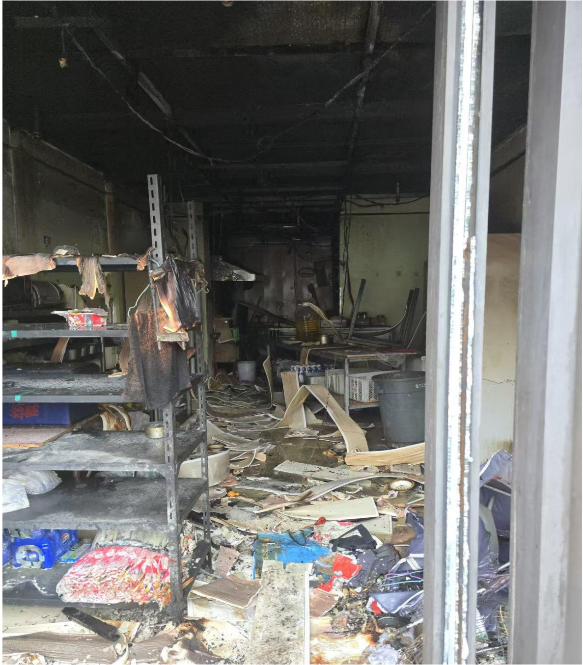
图 1 事故现场照片
