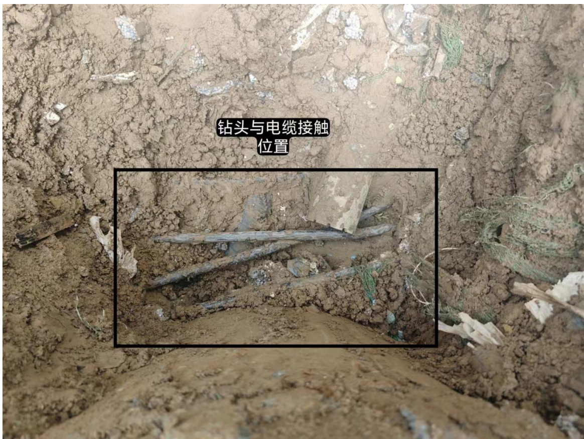
图三 水钻机钻头接触地埋电缆
