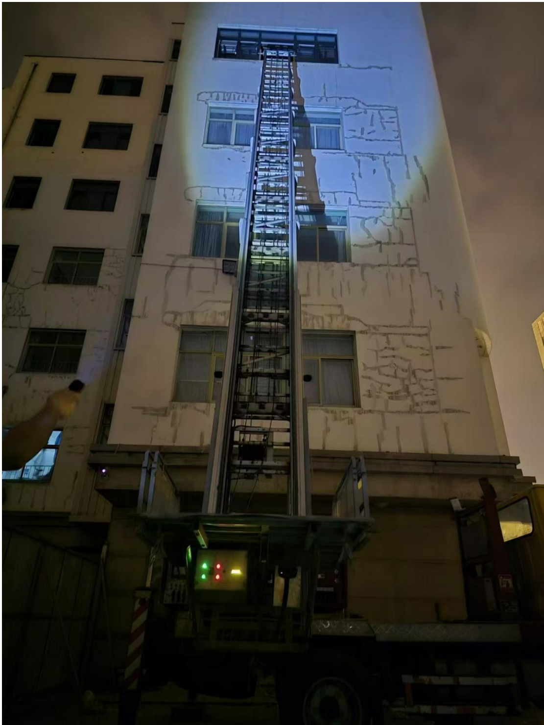
图三 事故发生当晚的高空作业车
