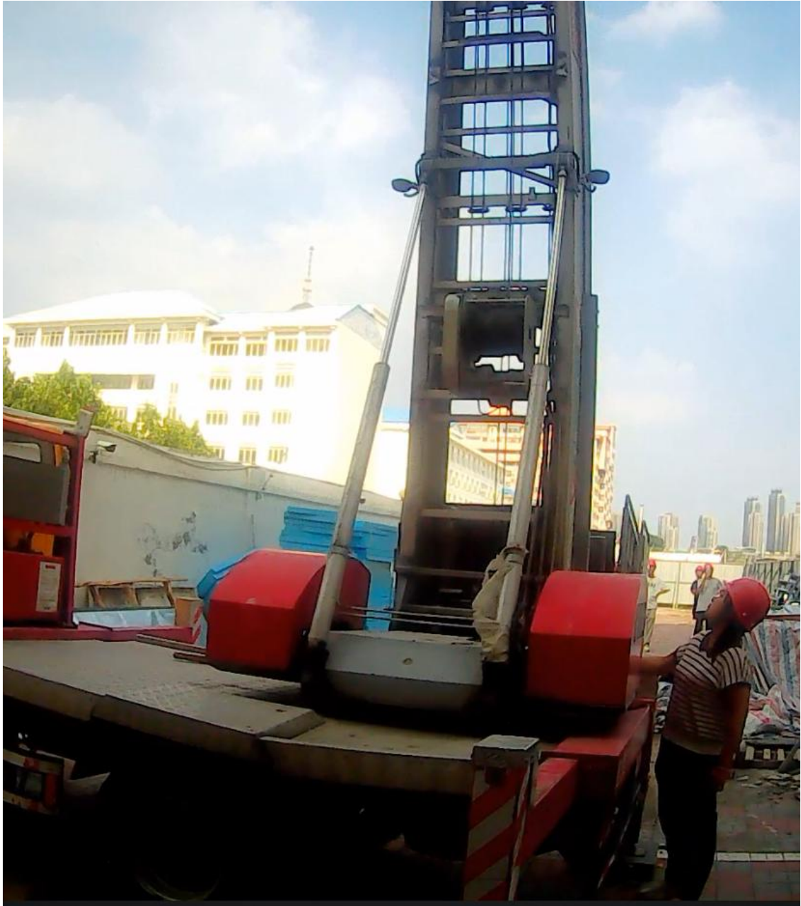
图六 云梯通电运行时钢丝绳始终处于紧绷状态
