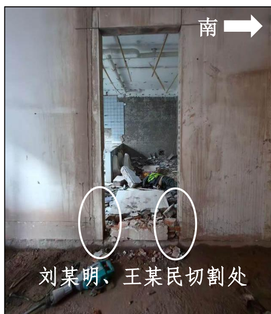
图 1 事发时切割的门洞底部与墙体连接处
