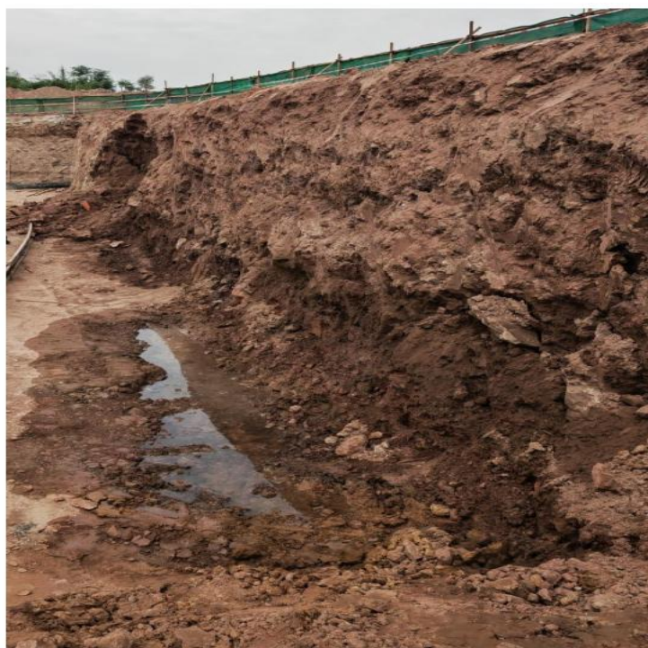
图十、坍塌部位左下部有积水
