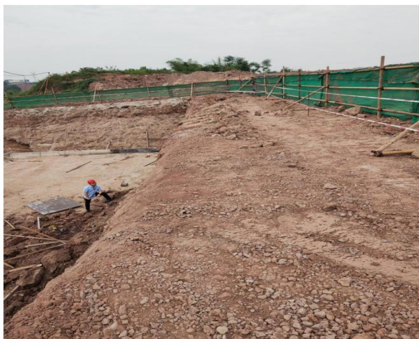
图十一、坍塌部位顶部局部有裂缝
