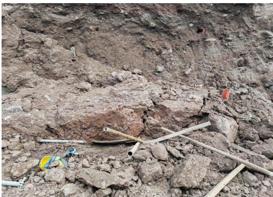
图七、坍塌部位照片三
