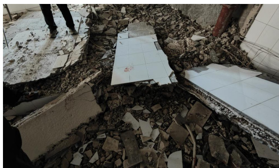
图 2 其余隔墙倾倒情况
