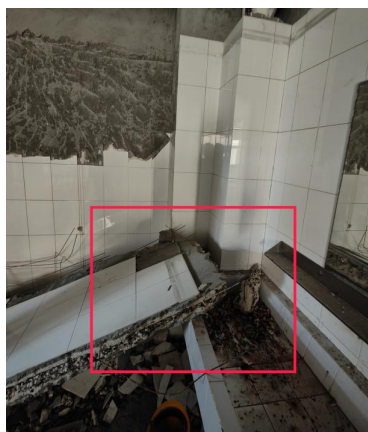
图 1 涉事隔墙倾倒情况
