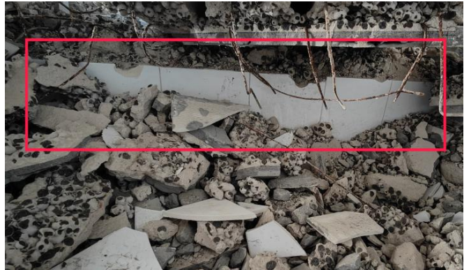
图 6 底部掏掘情况
