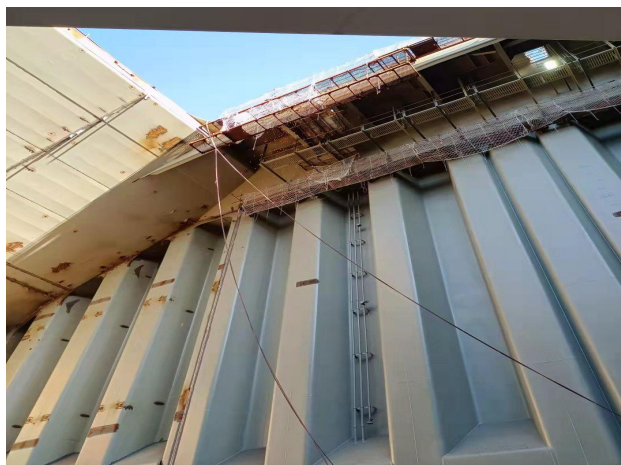
图 4 事发时 501 分段反顶平台悬挂脚手架动火作业情况
