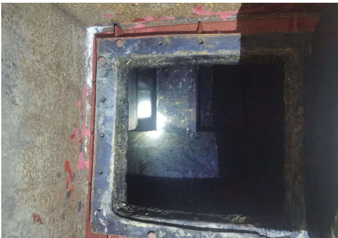
图1水轮机室现场图片
