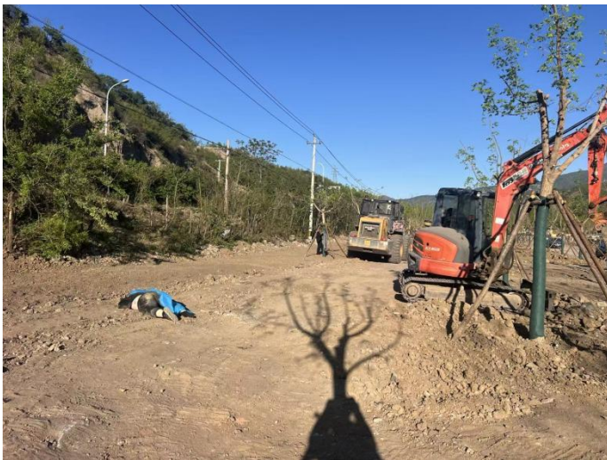
事故现场情况
