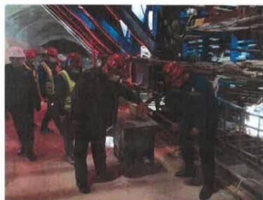
斜井左线小里程二衬台车木据检查
