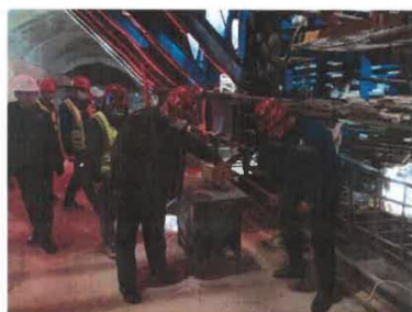
斜井左线小里程二衬台车木据检查
