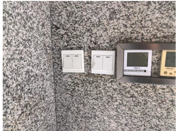
图4 照明灯控制开关
