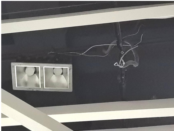
图3 电源线裸露情况
