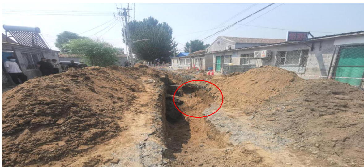
坍塌现场图示（自北向南拍摄）
