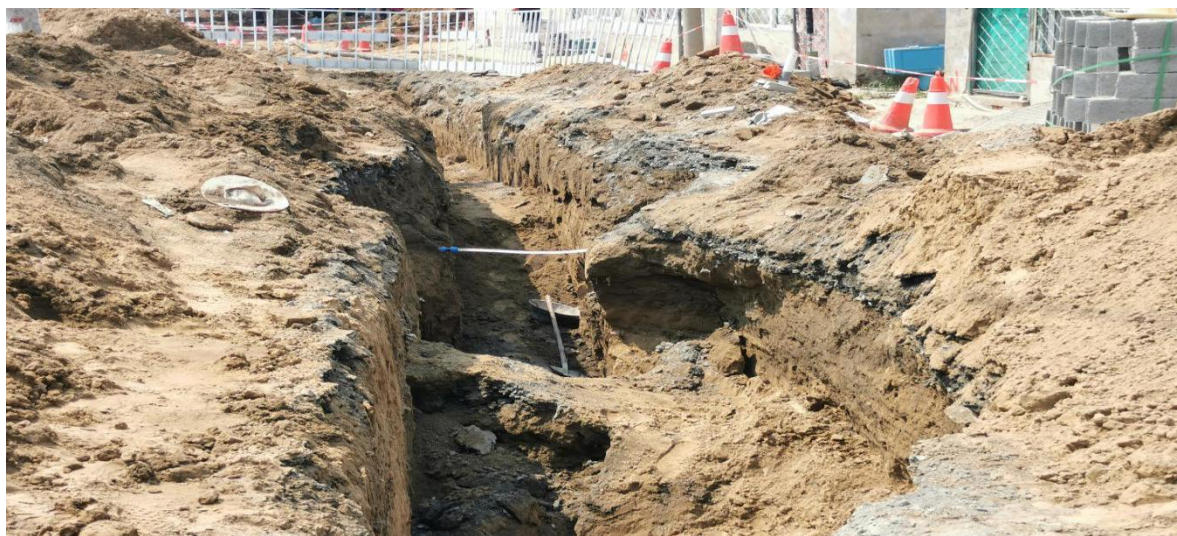
现场坍塌情况
