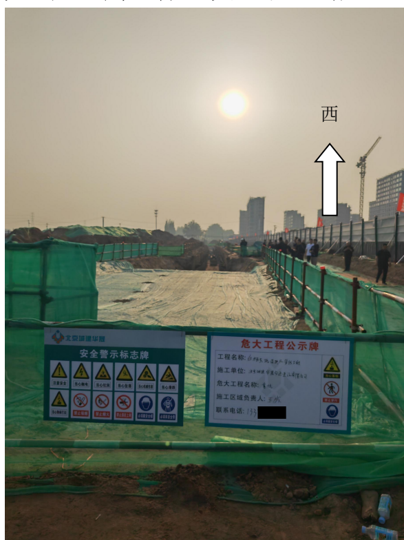
图 1 事发沟槽东侧
